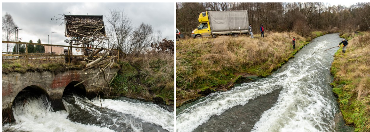
Fot. 1 i 2. Prace związane ze spławianiem biomasy prowadzone na Kanale „Dąbrówka” fot. M. Stobierski (3.12.2021)
